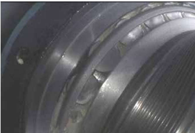
Figura 17: Boroscópio da extremidade do rodo da turbina 1
