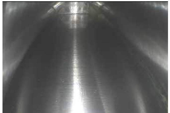
Figura 18: Boroscópio da pista/rolo da turbina 1
